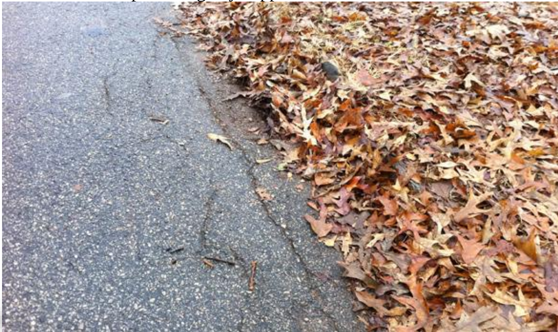
Fig. Edge Cracks
