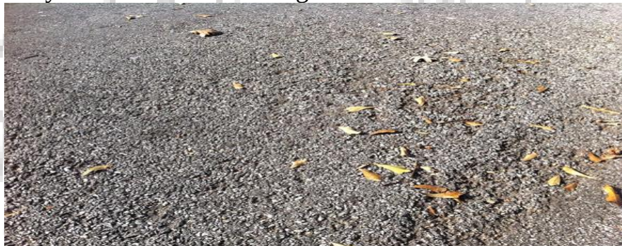
Fig. Raveling (very porous asphalt)
